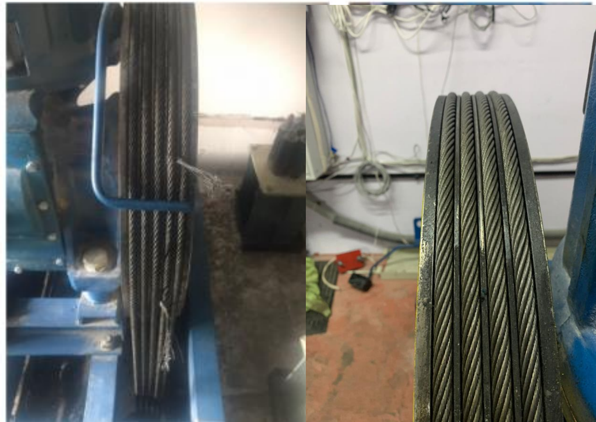
Тяговые канаты до ремонта
